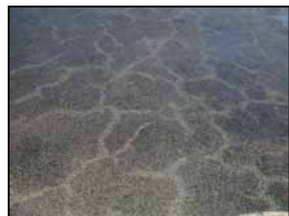
図-3 西郷1号岸壁上部工のひび割れ
