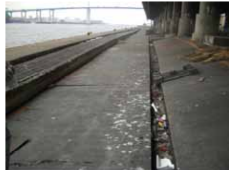
写真-2 エプロンの陥没、荷捌所との段差
