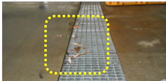
写真-1 荷捌き後のグレーチング廻り
